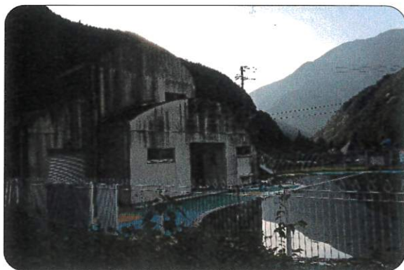
修繕が予定されているふれあいプラザとプール
